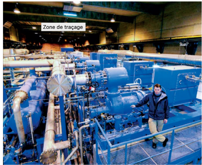
L'un des 8 groupes de compresseurs de réfrigération utilisés par l'actuel LHC (Image: CERN)
